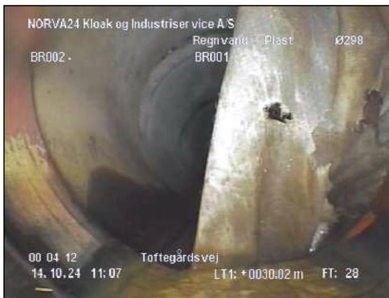
Figur 23. Blokeringen set med inspektionskamera
