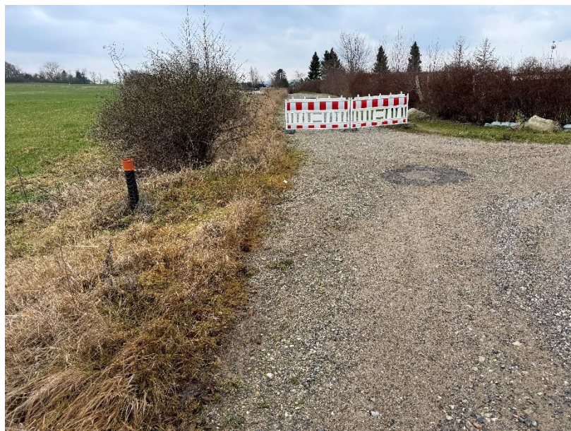
Figur 32. Afspærring af Røllikevej fra Toftegårdsvej til Ranunkelvej grundet erosion
